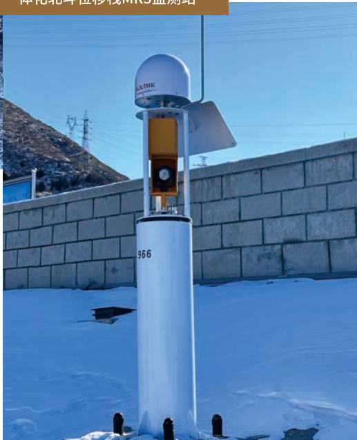
河北某大型水库 一体化北斗位移栈MR3监测站
