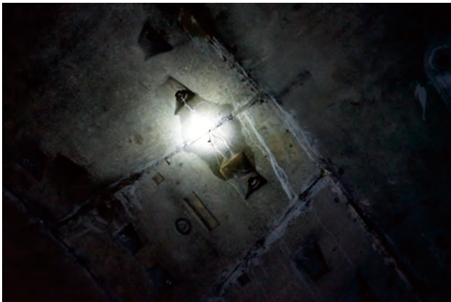
隧道盾构面病害区域
